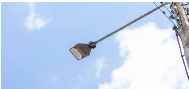
Oprawy po zakończeniu inwestycji pn. „Modernizacja opraw oświetlenia drogowego na terenie gminy Kostomłoty”
